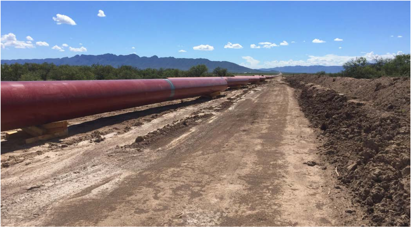
サグアロLNG輸出ターミナルに直結しているサグアロ・コネクター・パイプライン(米国側)およびシエラマドレ・ガス・パイプライン(メキシコ側)。両パイプラインが通る地域では、建設による生態系の破壊と運営リスクが危惧されている。
